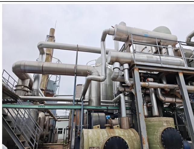
污水站废气处理措施：AOPs 高级氧化+碱液喷淋+活性炭吸附（含脱附）+DA046（FQ-13）排气筒
