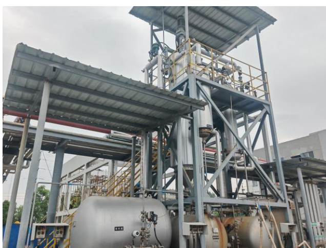
污水处理设施 2（高浓废水处理）
