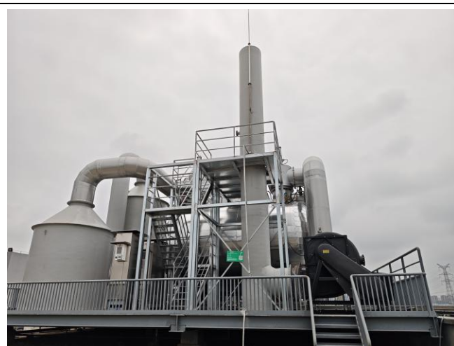
1#危废仓库废气处理措施：一级碱液吸收+一级活性炭吸附（含脱附）+FQ-27 排气筒
